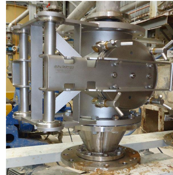
Ein Magnetfilter in Betrieb
